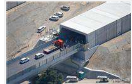
鉄板が落下したとみられる現場付近。作業員1人が下敷きになった＝19日午後2時13分、大阪府箕面市（本社ヘリから）
